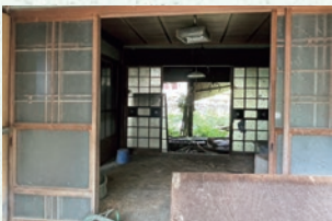
空き家の現状
